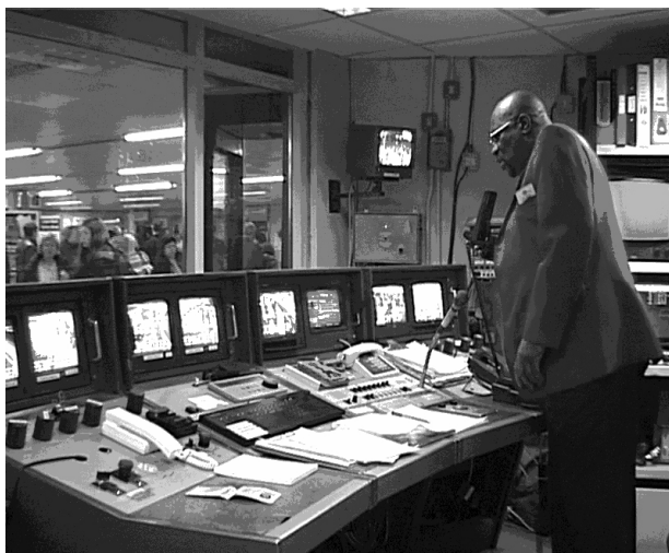
Fig. 1 La salle de contrôle de la Station de Victoria
